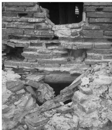
Figura 09. (2007. foto de los autores) Estado ruinoso de la estructura de apoyo del cuerpo octogonal
