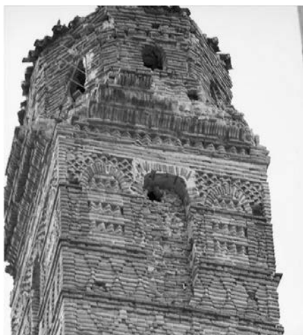
Figura 08. (2006. foto de los autores) Modificaciones en huecos para instalación de campanas, alero con pérdidas en los ángulos y transición a cuerpo octogonal
